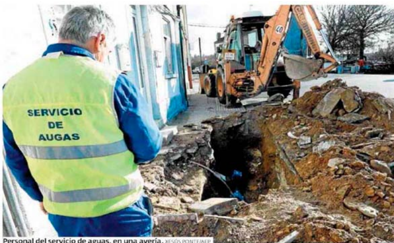
Personal del servicio de aguas, en una avería. JESÚS PONTEAEP
