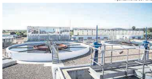
Planta potabilizadora de la capital extremeña.
