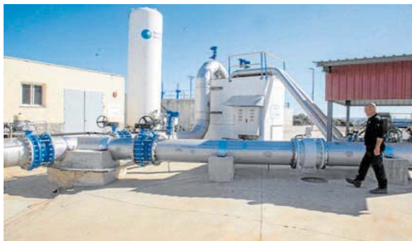
Sistema de bombas en la potabilizadora en la entrada del agua que llega de la presa de Alange. J. M. R.
