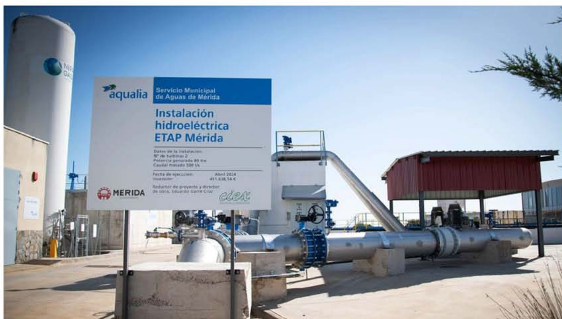
DEPURADORA AGUAS MERIDA
