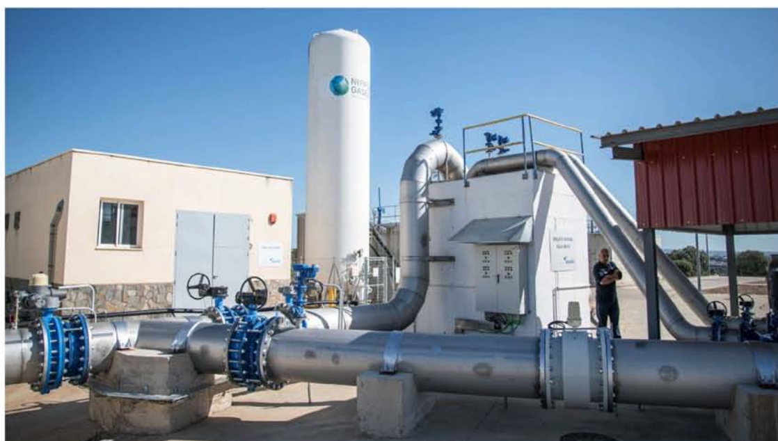
DEPURADORA AGUAS MERIDA 3
